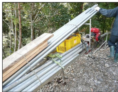
ラック積載物の固縛状況
