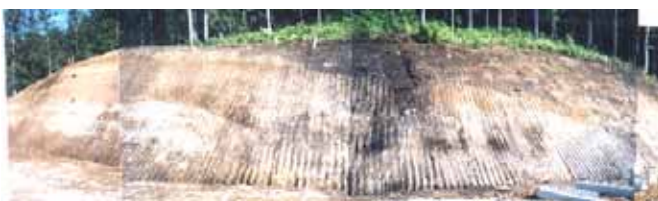
崩壊前のり面
