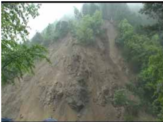
揖斐川町道下山線斜面崩壊(平成18年5月13日) (国交省越美山系砂防事務所HPより)
