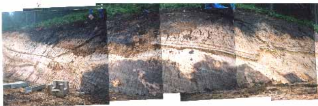
崩壊後のり面
