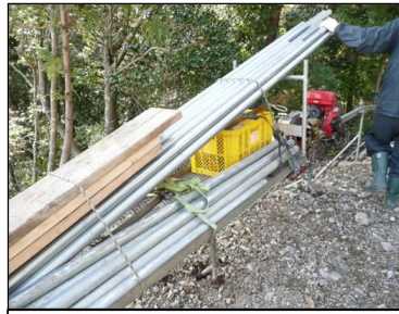
ラック積載物の固縛状況
