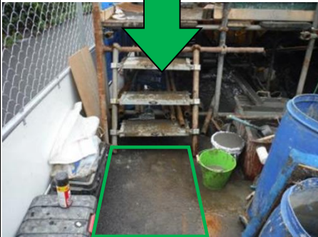
【改善後】作業通路の確保
