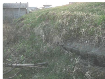
崩土に埋もれた石積み擁壁 (4/15)
