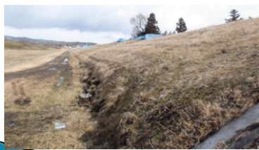
川表側のり戻のはらみだし (3/16)
