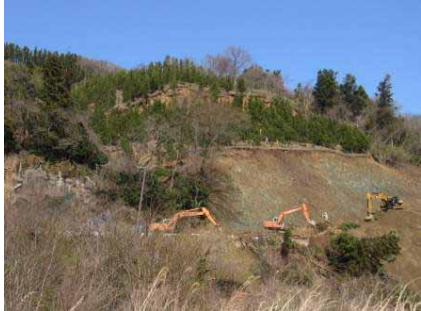
写真 - 11 地すべり部分の末端部
