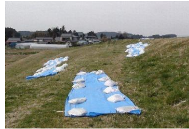
裏小段の亀裂 (4/15)
