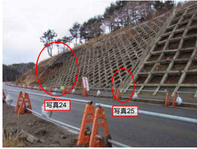
写真23 津波によるプレキャストのり枠工の被災現場
