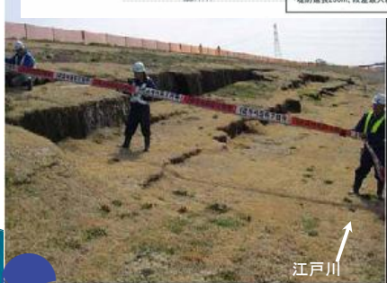
FVRI 川表側のり面の陥没(地震発生直後)
