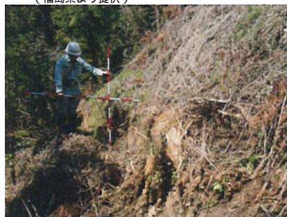
写真 - 14 表層崩壊部分の上部斜面の亀裂、段差 (福島県より提供)
