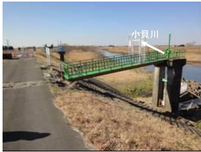
下流側の樋門管理橋の落座 (3/18)
