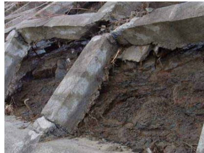
写真29 のり枠交点部の破壊
