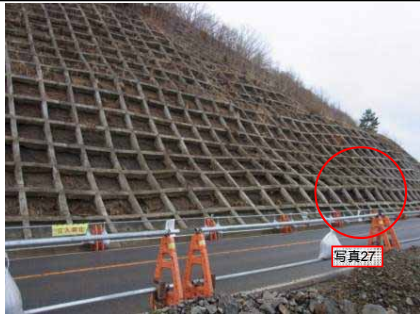
写真26 津波による現場打ちコンクリートのり枠工の被災現場
