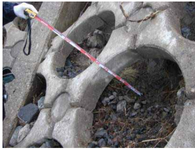
写真25 プレキャストのり枠工背後の土砂流出による隙間
