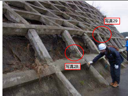
写真27 コンクリートのり枠工の被災状況
