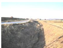
崩土が川裏側の水路を閉塞 (3/18)
