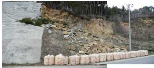
岩手県一関市巖美町下真坂(一般国道397号)のやや一関側 (平成20年度災害で落ち残った古いモルタル箇所が崩壊。緩み残りありと推定) (左写真はH21.6月、右写真はH23.4月)
