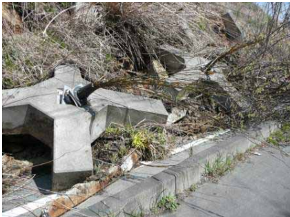
写真19 被災したグラウンドアンカー工
