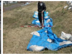
裏小段の沈下、傾斜 (4/14)
