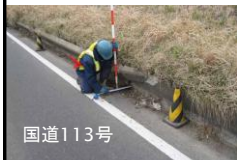
裏のり尻部の擁壁の倒壊 5)
