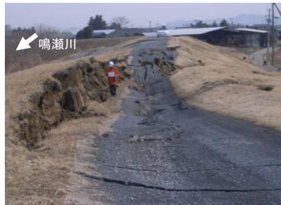
天端の沈下, 陥没 (3/13)
