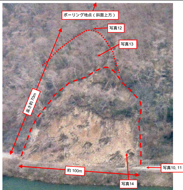
写真9 斜面崩壊による国道の被災 (写真提供：仙台河川国道事務所) 赤破線：崩壊範囲 赤点線：上部斜面に生じた滑落崖
