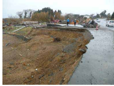
写真32 津波による盛土の被災 盛土が流失した部分では下端の擁壁が失われた。
