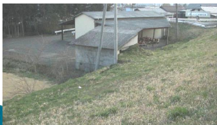
民地に達した崩土 (4/15)
