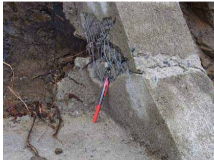
写真28 のり枠部材の破壊
