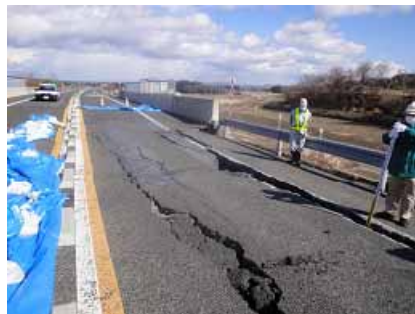
写真8 盛土上面（路面）の亀裂
