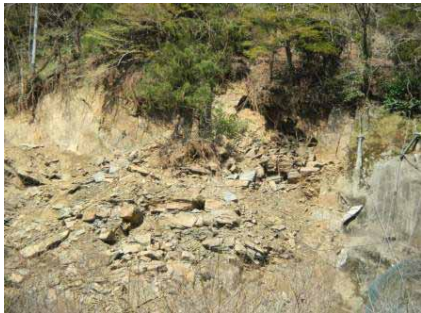
写真 - 13 岩盤崩壊部分
