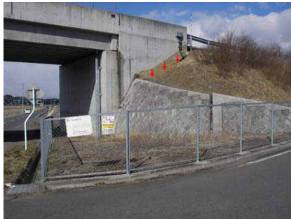
写真6 県道盛土の沈下（赤矢印）
