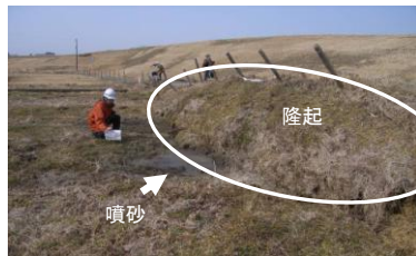
川裏側の基礎地盤の隆起と噴砂 (3/13)
