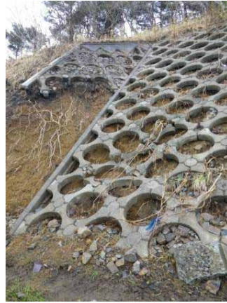
写真24 プレキャストのり枠工の被災状況
