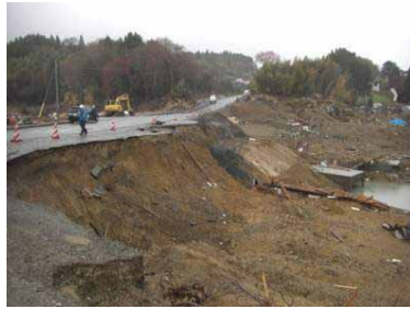
写真31 津波による盛土の被災
