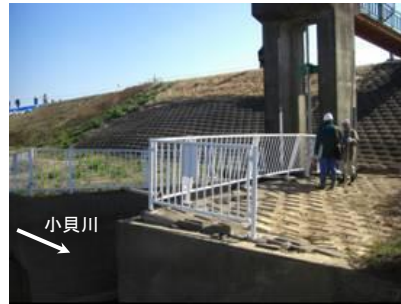
翼壁天端部の沈下 (3/18)
