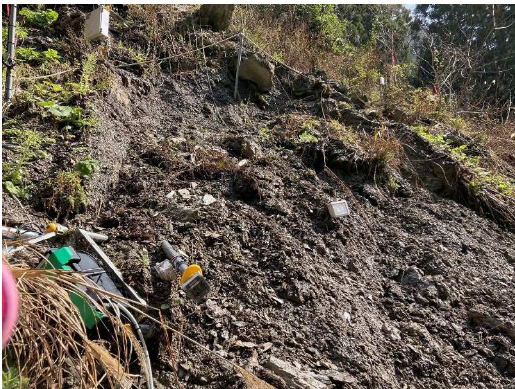
写真3-2 崩壊の滑落崖付近の状況
