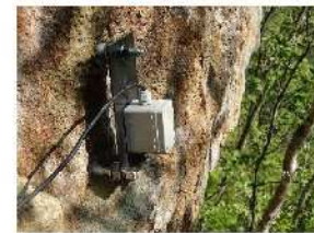
センサーの設置(転石・浮石)
