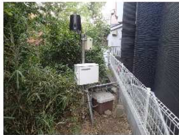
通信基地局の設置状況
