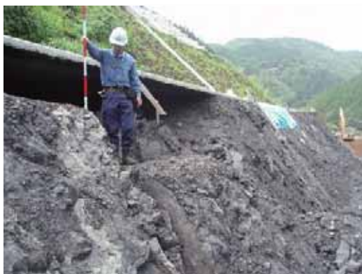
小規模な法面崩壊（勾配 1:1.0）
