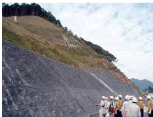
異常時の対応： 法面の微小クラック発生箇所に対する 関係者の現場協議
