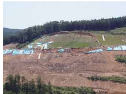
降雨後の比較的大規模な崩壊
