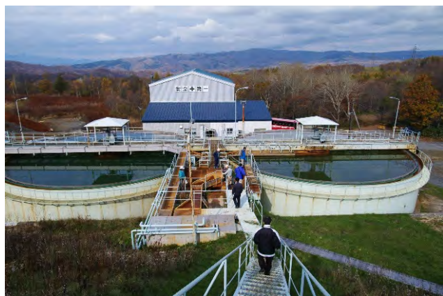
写真-2 鉱山からの酸性排水の処理施設
