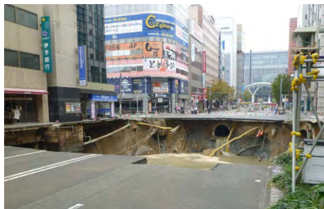
写真-1 福岡駅前のトンネル工事に伴う道路陥没(福岡市HPより) 7)
