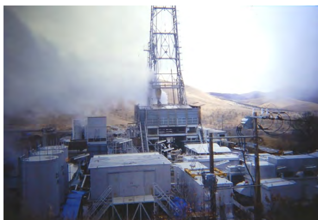
写真-1 八丁原・大岳地熱発電所
