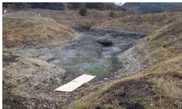
写真1 当初の評価対象となった現在の池(排水路)ヘドロが1m程堆積している。左岸は密実なマサ状強風化岩、右岸は軟質な土砂で、湧水が見られる。
