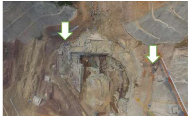
写真-6 NNP1基礎掘削中のドローン空撮写真、矢印先2か所でボーリング作業を行っています。
