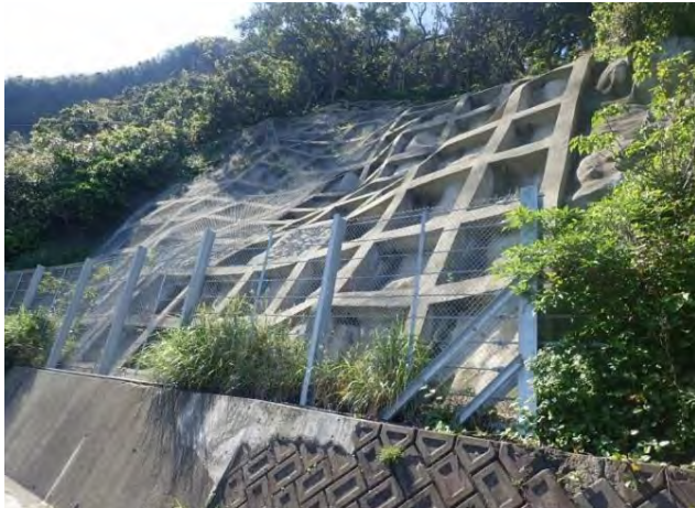
写真5 谷山地区対策工実施後状況 法枠工で復旧され、湧水箇所には栗石詰めが施工された。
