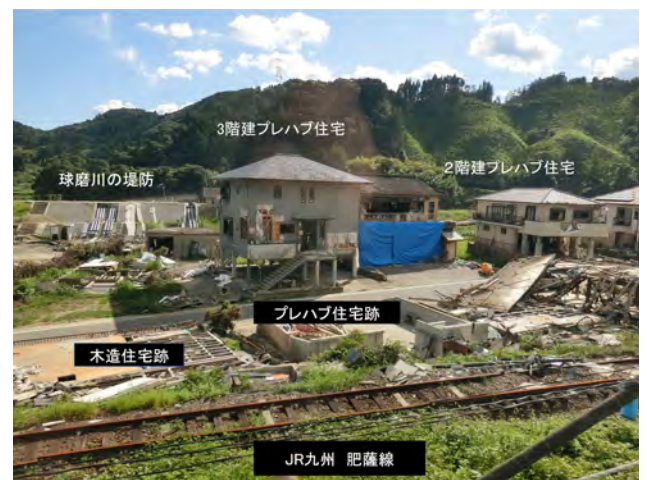
写真1 令和2年7月豪雨で被災した熊本県球磨川流域の人吉市の被害。ビロティ構造の住宅の2階の天井まで浸水した。
