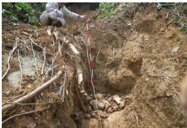
写真8 片浦地区の崩壊斜面 崩積土（上）と花崗閃緑岩（下）の境界から毎分0.5リットル程度の湧水が認められる。
