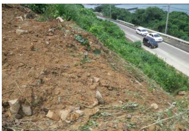
写真9 片浦地区の崩落土砂状況 斜面に残存する崩土は降雨に伴う表流水によって浸食され易く、崩土内の礫が落石となって落下することが考えられる。
