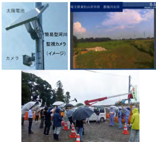
写真5 簡易型河川監視カメラの設置状況と住民説明状況（東松山市正代地区）
