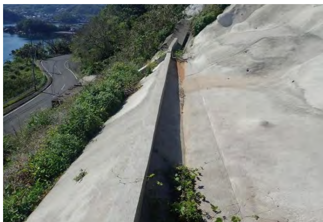
写真11 片浦地区の対策実施状況 法面中段に縦断排水溝を設置。
