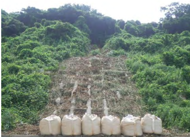
写真6 片浦地区の被災状況 法枠工上方の自然斜面が崩落し、泥流状の土砂が道路に達した。
