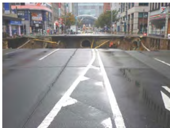
写真-1 福岡市地下鉄七隈線延伸工事現場における道路陥没事故の状況 1)
