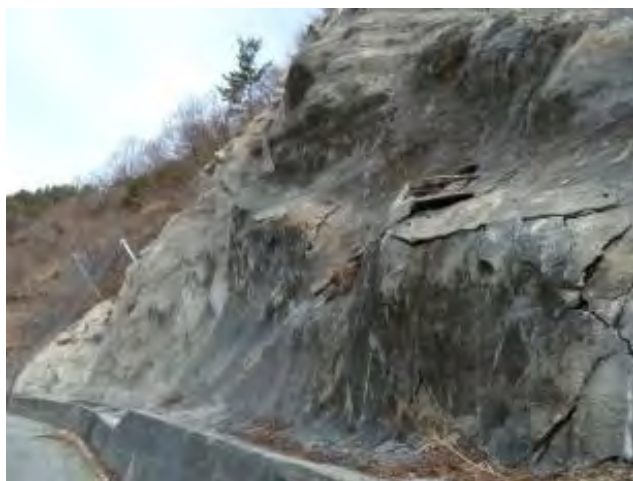
写真3 重力性変形で発生した法面の変形
