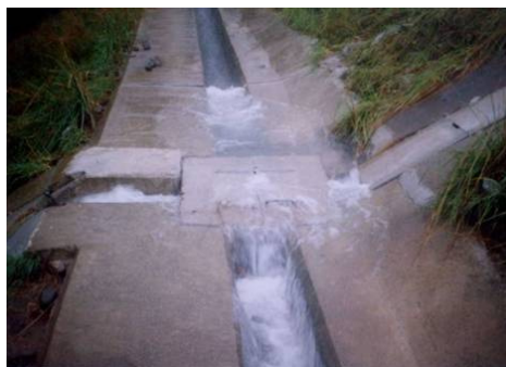
図-3 小段排水施設の溢水
