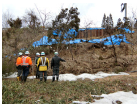
図-1 盛土のり面の変状
