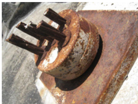
図-2 アンカーの腐食
