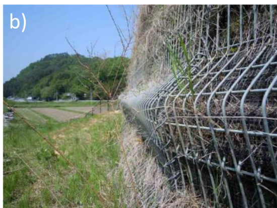
写真1 高速道路橋台（建設中）の補強土壁の地震被害事例 8) 、a) 全景、b) 下部の詳細
