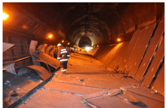
写真5 天井板落下事故 (笹子トンネル) ニューススイッチ (日刊工業新聞) より https://newsswitch.jp/p/1700-2
