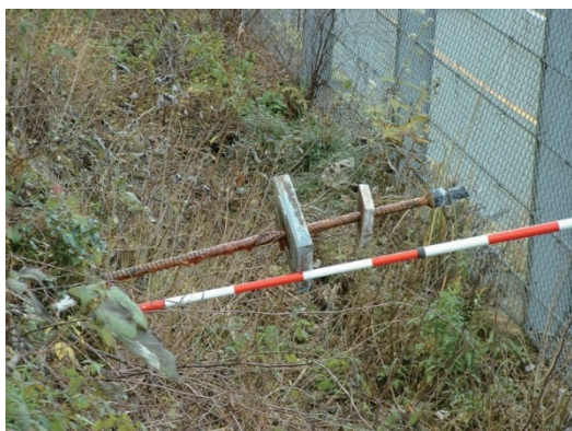
図-01 劣化破断により飛出したアンカー工
