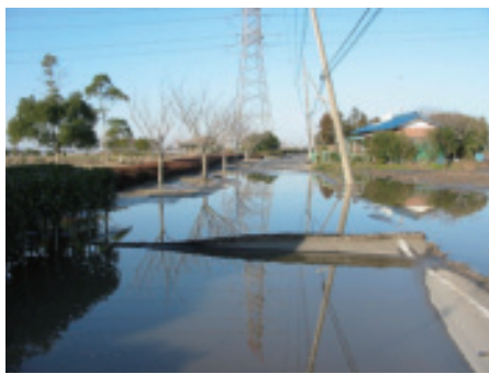
写真2 旧河道での液状化による滞水 8)
