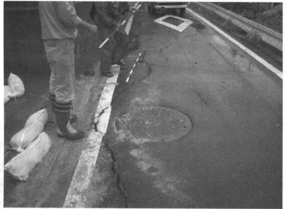
写真2 被災時の路面の亀裂
