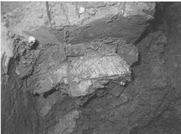
写真10 泥岩中の主すべり面（C集水井）
