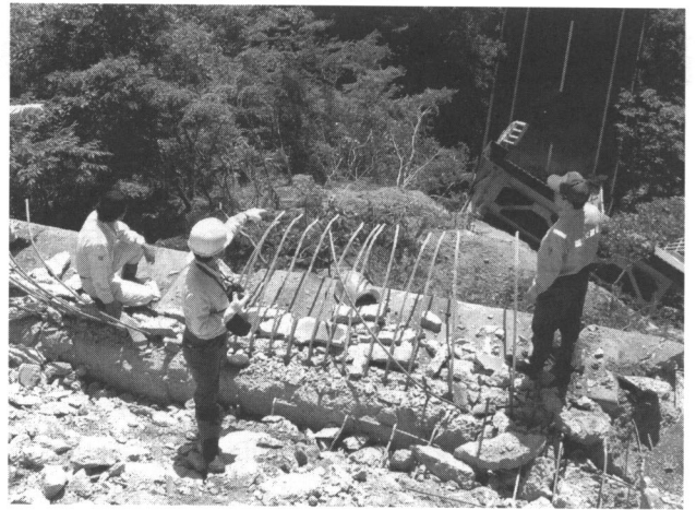
写真3 被災状況調査班（道路）
