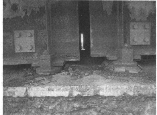
写真1 支承の台座コンクリートの破損
