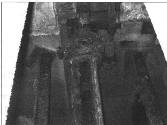
写真1 処理場施設の老朽化状況①
