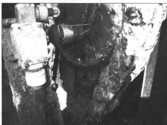
写真2 処理場施設の老朽化状況②
