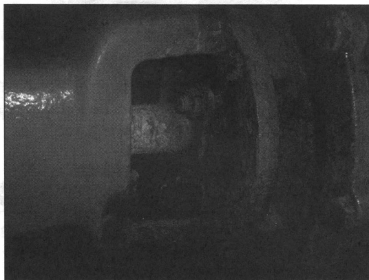
写真3 処理場施設の老朽化状況③
