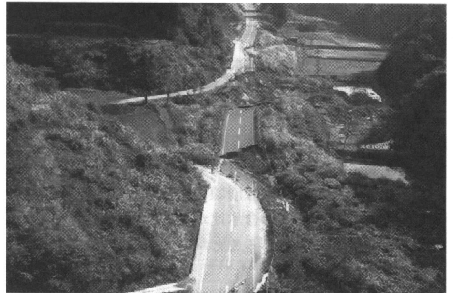
写真1 一般県道大沢小国小千谷線の盛土崩壊事例 (新潟県提供)
