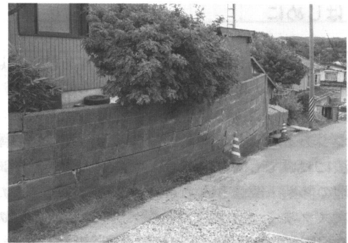
写真2 ブロック塀を擁壁の代替として利用した土留め壁の被害例(新潟県中越沖地震, 2007)
