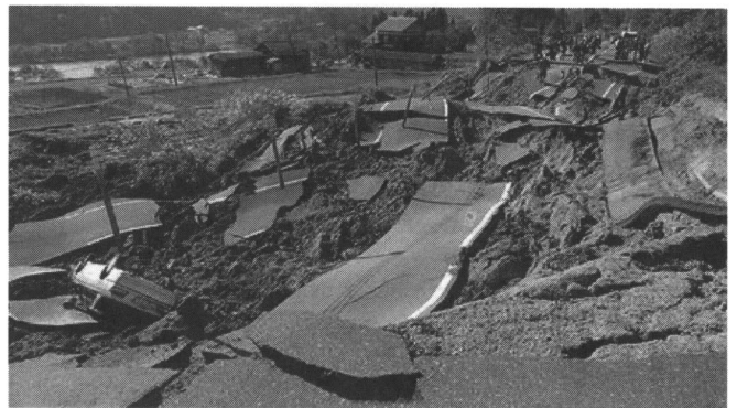
写真2 国道117号の盛土崩壊事例
