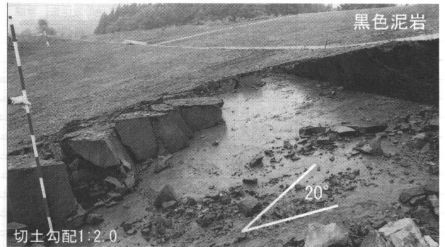
写真1 崩壊状況 (事例1)
