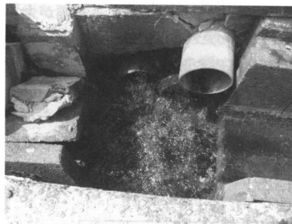
写真4 常時ドレンから排出されている敷地内の地下水（左下の排水管が敷地内ドレンによるもの、右は別の排出管）。
