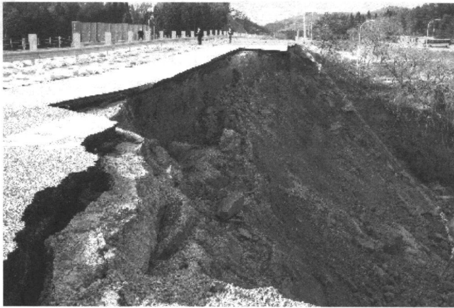
(a) 崩壊状況
