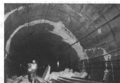
図5 新潟県中越地震での上越新幹線魚沼トンネルの被害 6)
