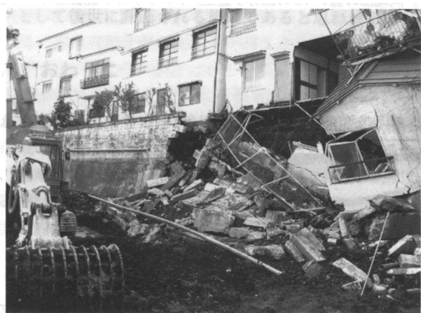
写真2 西品川の“崖っぶち”で発生した小規模な崩壊
