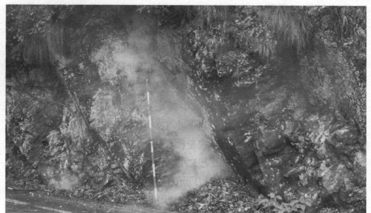
写真3 噴煙トレーサーによる分離亀裂確認状況
