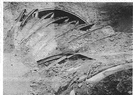
写真3 鋼製支保工の変形状況
