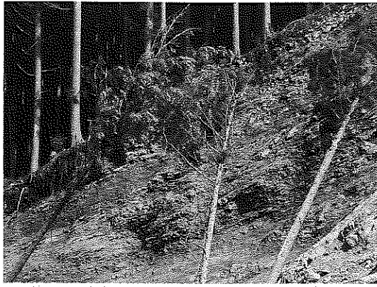
写真3 地すべり左側側方崖上部の状況
