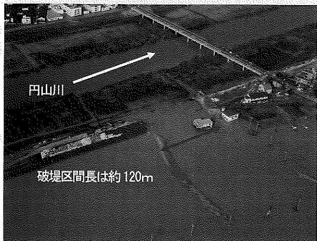
写真1 円山川右岸13.2kの破堤状況
