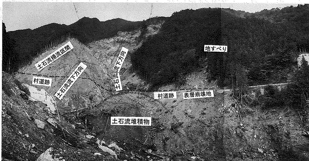
写真1 大用知崩壊地全景(土石流発生源)
