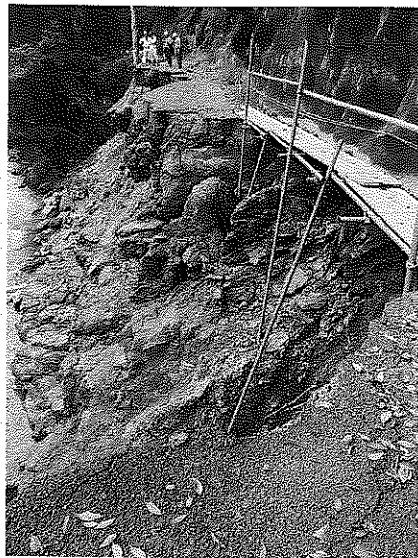
写真1 路肩崩壊状況
