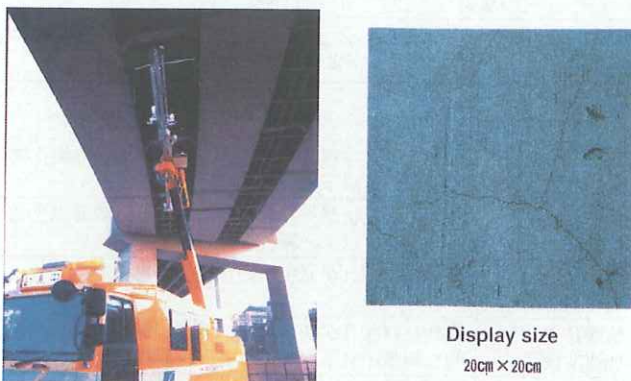
図8 レーザーを利用したコンクリート表面計測(首都高速道路技術センター)
