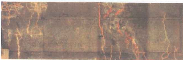
図7 デジタルカメラによる画像とひび割れ分布 6)
