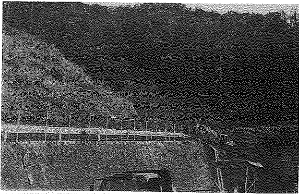
写真4 集中豪雨後の斜面崩壊
