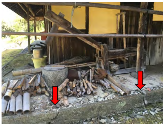
写真4 家屋の土間コンクリートに現れたズレ
