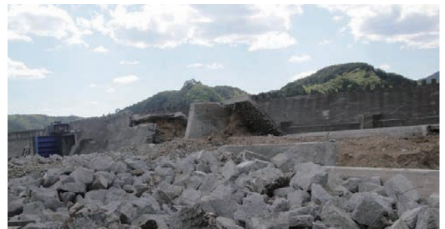
図-3 田老町の防潮堤の被災状況
