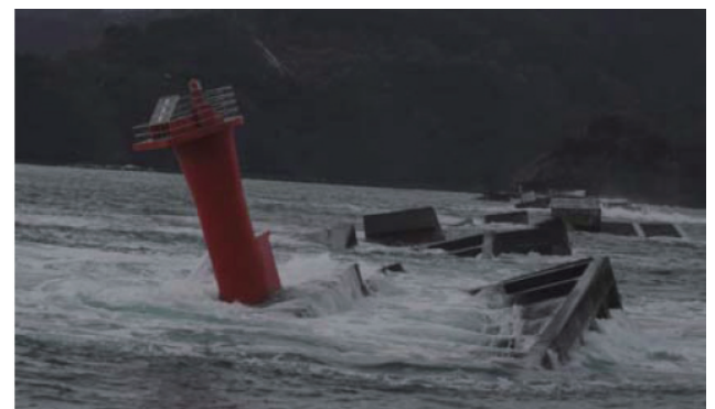
図-4 釜石湾口防波堤の被災状況
