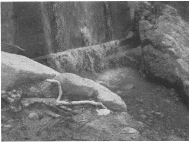
写真9 砂防ダム下流側洗掘状況
