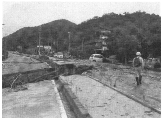
写真 2 突き上げられた国道交差部の勝坂橋
