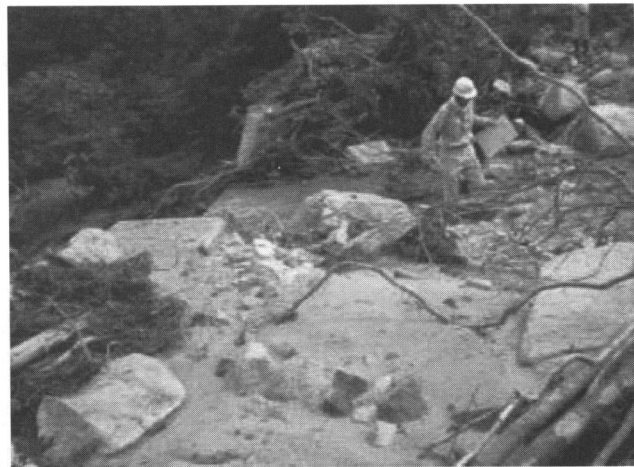
写真11 砂防ダム上流側満砂状況
