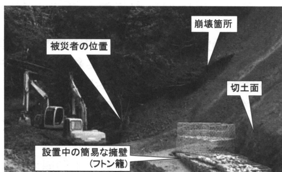
写真1 斜面崩壊による労働災害の事例
