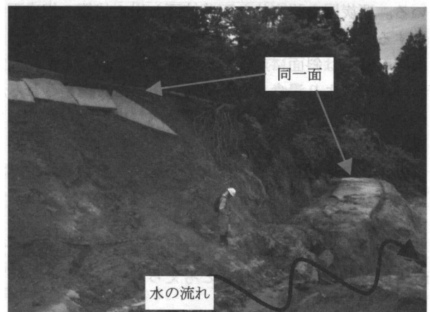
写真4 河岸段丘面に通じる道(池からの流水により道下の土砂の大部分が流出し、道の一部が落下している)
