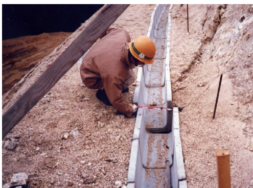
写真③ 古い地すべり土塊の掘削による変位の発生
