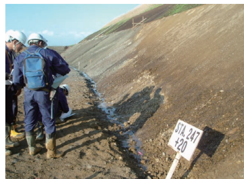
写真④ 湧水による法面の不安定化
