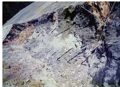
写真② 断層破碎部の補強対策後の崩壊発生
