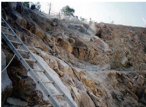
写真① 中硬岩の流れ盤法面の掘削に伴う不安定化
