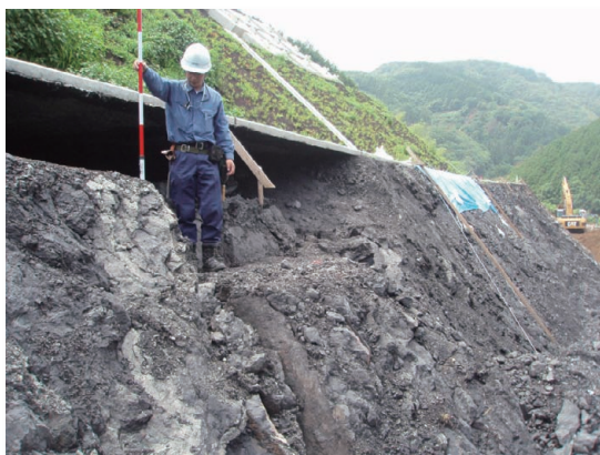
小規模な法面崩壊(勾配 1:1.0)
