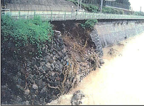
図 3.2.11 河川の護岸浸食の例 岐阜県飛騨市古川（宮川沿い）
