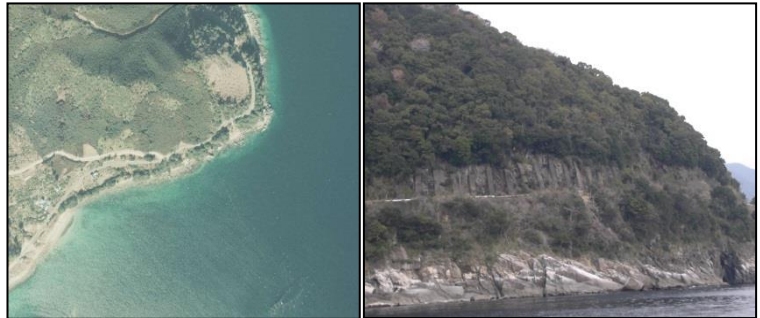
図 3.2.15 リアス式海岸の例（三重県尾鷲市賀田湾） 海岸浸食により岩盤が緩み、道路まで変状が及んでいる
