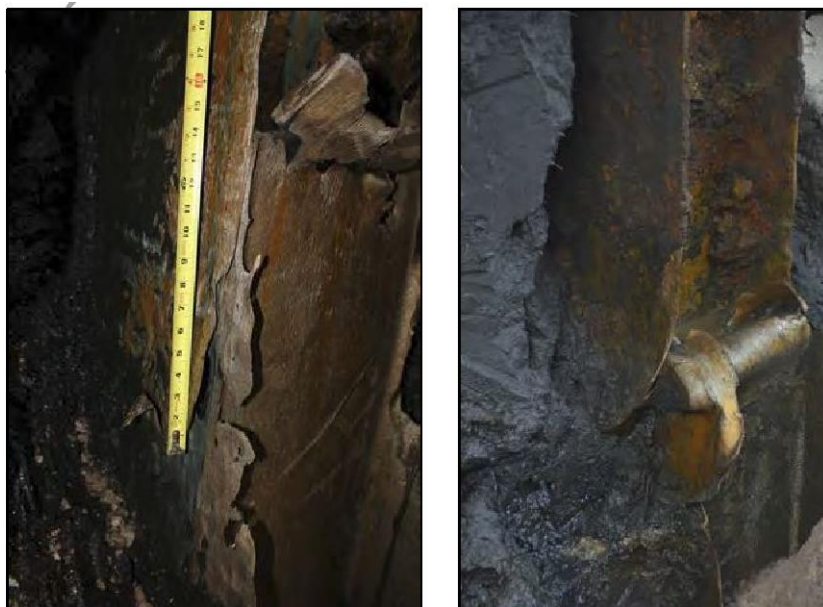
(腐食したH鋼基礎杭)
