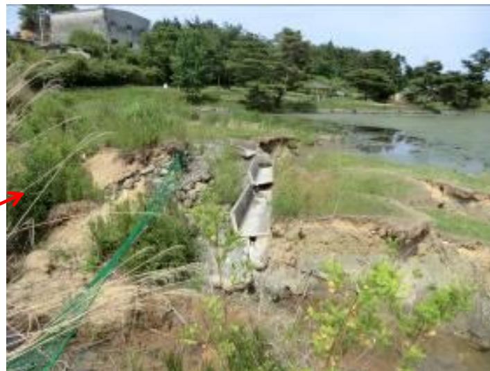
公園内は沼地周辺をミニゴルフ場として整備。崩壊箇所はその部分が大きく（20m程度）流動しており、基盤面の液状化に伴う側方流動による崩壊と推定される。
