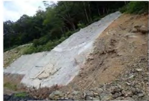
写真1 変状斜面全景
