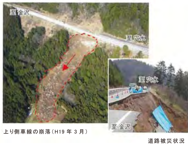
写真 1.1 令和6年能登半島地震による道路盛土の被災例 4)
