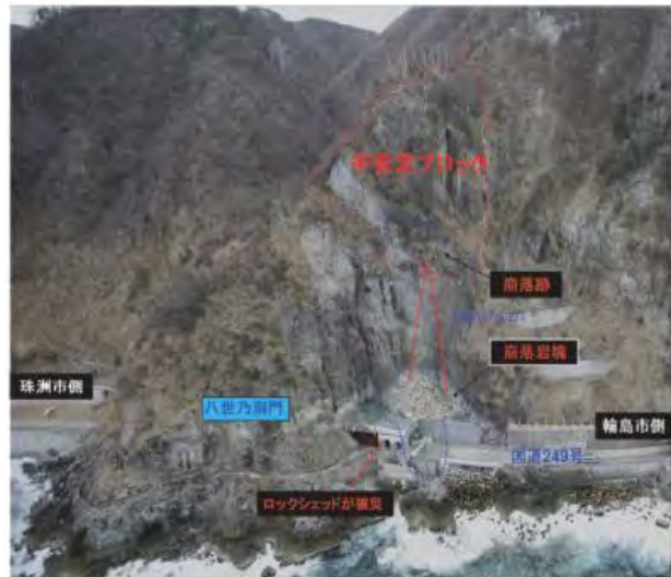
図2 八世乃洞門被災状況全景(H19.3末被災時)
