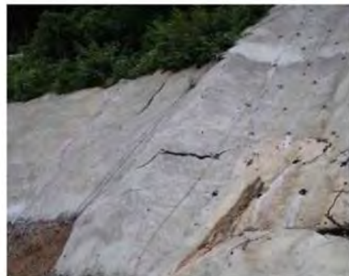
写真2 モルタル吹付に発生したクラック
