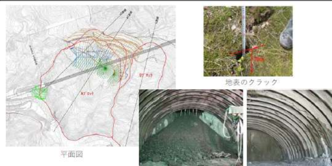
トンネルの掘削施工中にトンネルの内外で地すべりによる変状が発生
