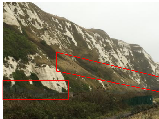
斜面下部の高エネルギー吸収型落石防護工
