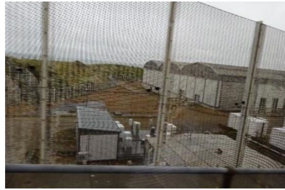
写真 19 トンネル管理設備
