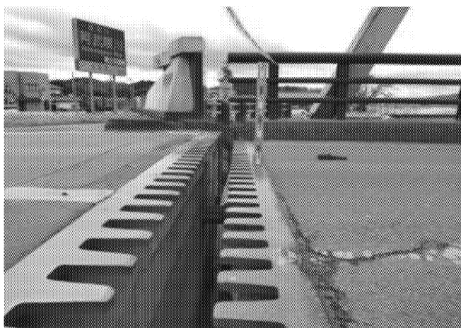
写真 2.13.1 伊達橋の損壊状
