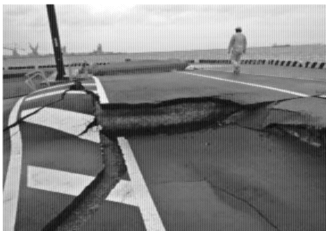
写真 2.13.2 相馬港 3号ふ頭の被災状況
