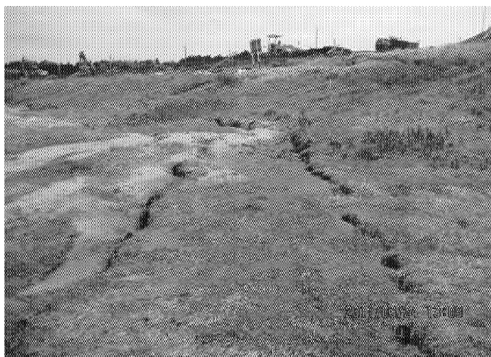
写真 2.1.2 地震に伴う河川堤防法尻の噴砂
