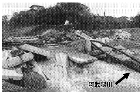
写真 2.10.3 阿武隈川上流の決壊箇所
