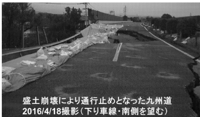
写真 2.5.3 盛土崩壊により通行止めになった九州自動車道
