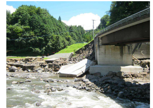
倒壊した橋台取付部の擁壁
