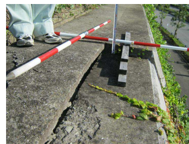
擁壁天端の段差
