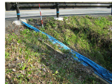
のり面の浸食
