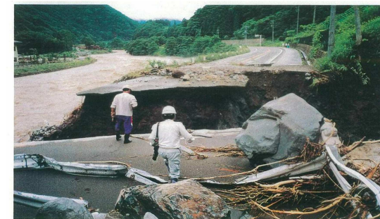
土石流により路体が流出し道路が切断
