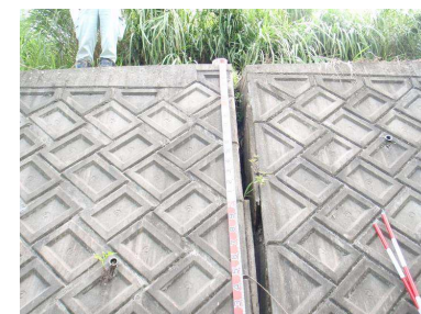
擁壁目地の開口
