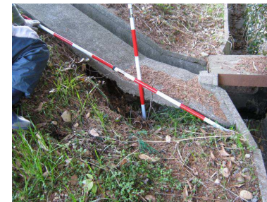
排水路基礎の洗掘
