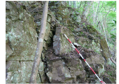
不安定な浮石
