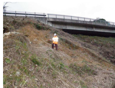
のり面の崩壊
