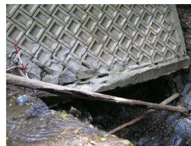
擁壁基礎の洗掘
