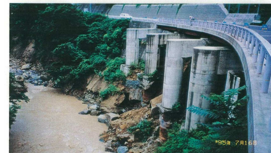
溪岸が浸食を受け、橋脚基礎杭が洗掘により露出
