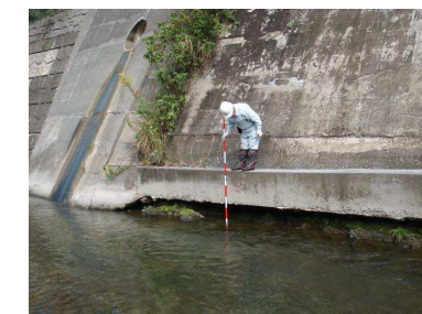
擁壁基礎の洗掘
