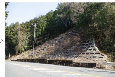
B-2) 現地確認で切土には判読された崩壊地形も含めて吹付けのり枠工が施工されていることを確認
