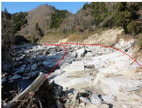
道路盛土区間の流失
