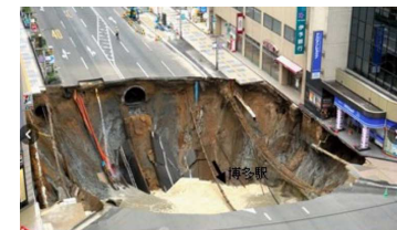
出典: 福岡地下鉄七隈線延伸工事現場における道路陥没に関する検討委員会報告書(土木研究所HP)、福岡市交通局撮影
