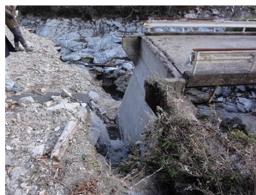
河川水による橋台背面盛土の流失
