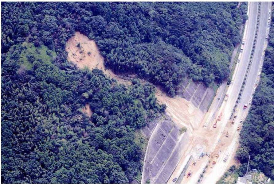
2009.7.26 福岡県大野城市(九州自動車道) 谷埋め堆積物を主体とする谷頭斜面の土砂崩壊。道路から見えない谷頭斜面の状況に注意。
