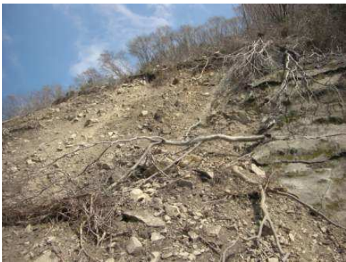
上写真：切土のり面の地質は破碎質
