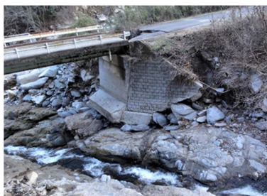
河川水による橋台基礎洗堀
