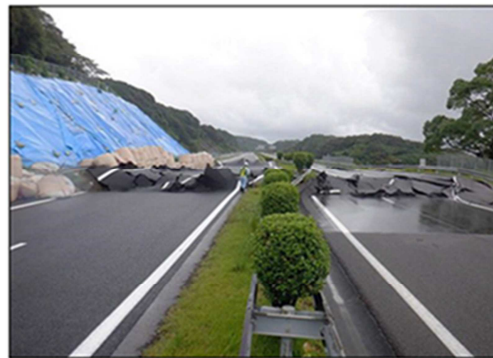
道路の隆起状況（NEXCO西日本撮影）
