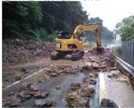
土石流による国道の被災状況 （岩手河川国道事務所資料）
