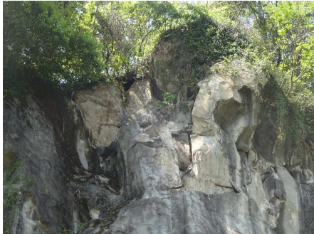
国道445号(熊本県御船町): 落石 溶結凝灰岩の急崖から発生
