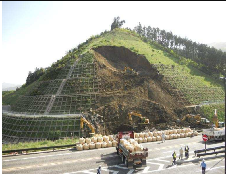
鳥取自動車道智頭ICランプでの崩壊(H23. 5月) (施工時に小崩壊があった箇所の上部が大きく崩壊)
