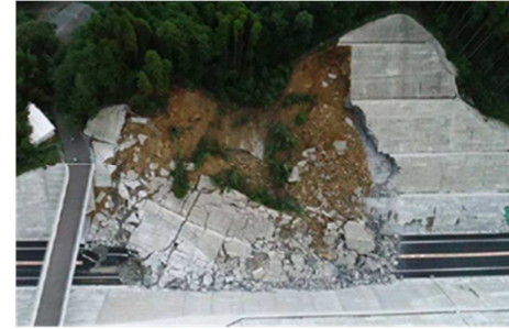
供用1年以内のり面の崩壊 （佐賀国道事務所）
