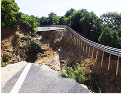
溪流横過部の盛土崩壊 (NEXCO西日本撮影)
