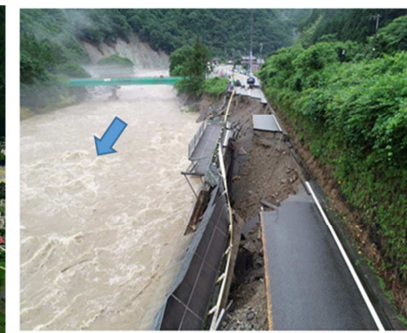
護岸の被災状況（高山国道事務所）
