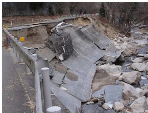
基礎洗堀による擁壁の倒壊
