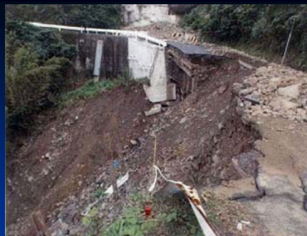
平成24年の路肩崩壊
