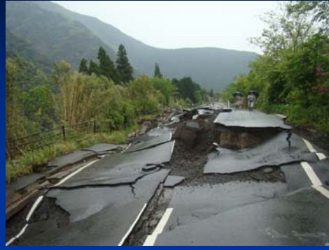
村道栃木-立野線 波打つ舗装面
