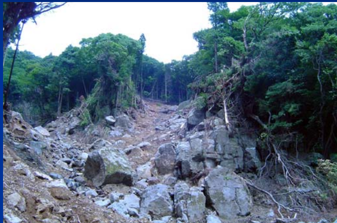
源頭部の崩壊状況 表層崩壊の衝撃で溶結凝灰岩からなる急崖が崩壊
