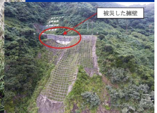
海岸に向かう急斜面中腹の道路 繰り返し崩壊、土砂流出、 海岸浸食が発生 道路上下に抗土圧型の 土構造物で抑止される。
