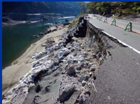
球磨村神瀬のブロック積み擁壁と盛土の崩壊 * 基盤岩は石灰岩
