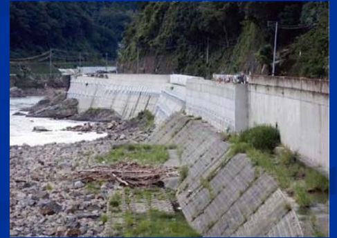
球磨村 親杭横パネル壁工は路面まで水位が上昇しても崩壊に至っていない。
