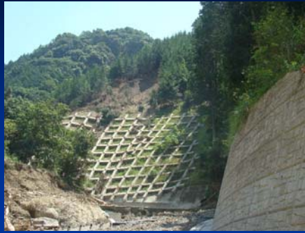
枠工は健全なまま残留 上部斜面は崩壊 路体は侵食される
