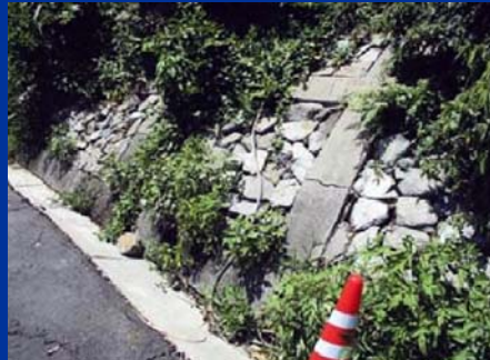
平成28年の砕工の変状(砕に水平亀裂)
