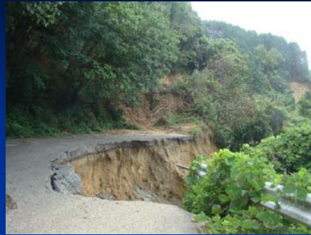
道路からの表流水による路肩の洗掘
