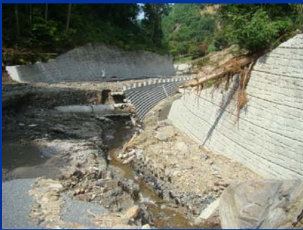
尾根近くで洗掘された路体 急カーブする水衝部
