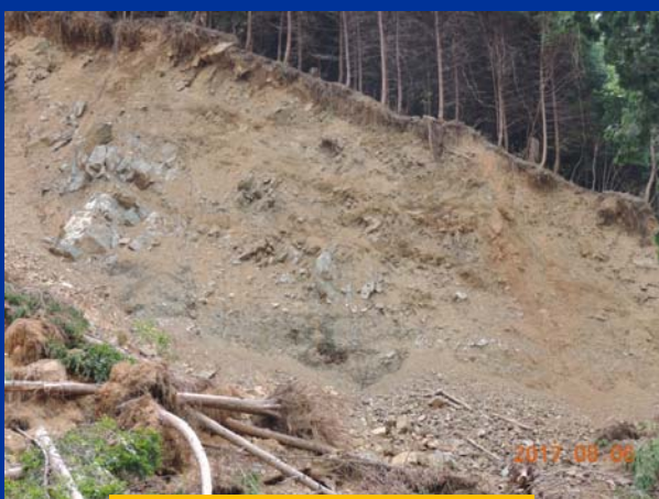
乙石川源頭部 崩壊面
