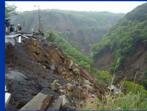
橋手前の白川に向かう斜面崩壊
