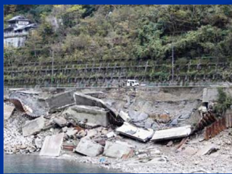
球磨村土留め壁の崩壊 * 斜面側ののり面保護工には変状が認められない。
