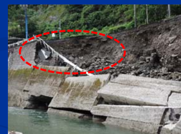
終点側で崩壊した護岸擁壁の背面は岩塊からなる盛土
