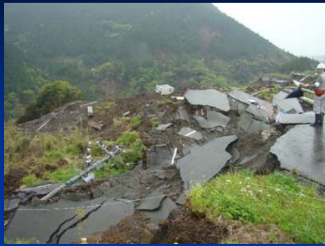
村道栃木-立野線 崩壊箇所
