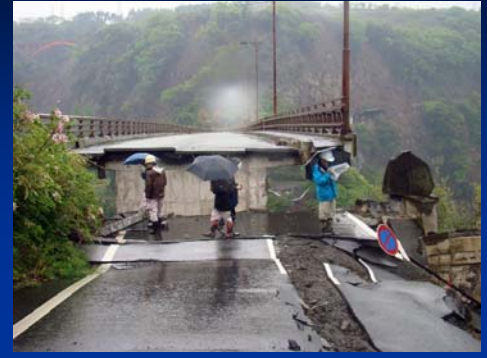
阿蘇長陽大橋の2m近い段差
