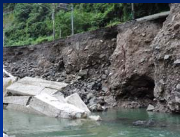
護岸擁壁の崩壊
