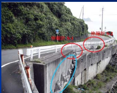
令和2年7月8日 路面のクラック拡大
