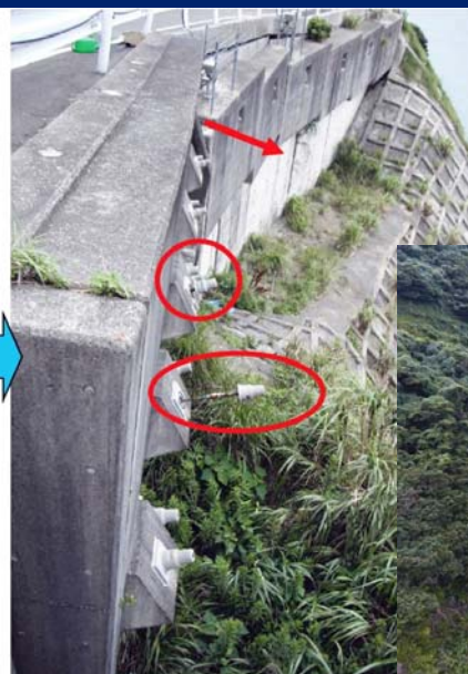
令和2年災 7月14日 アンカー工の破断 擁壁工の前傾
