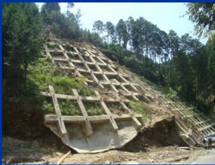
洗掘された枠工脚部
