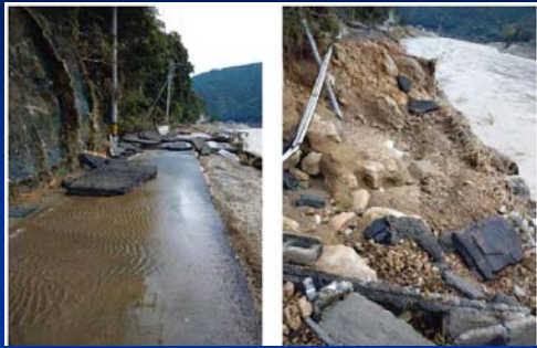
八代市坂本町付近の盛土崩壊 * 流水によって舗装が捲れた状況
