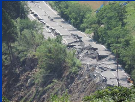
村道栃木-立野線の舗装の変形
