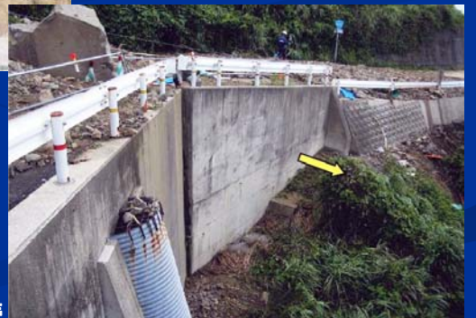
平成22年 擁壁の前倒れ状況
