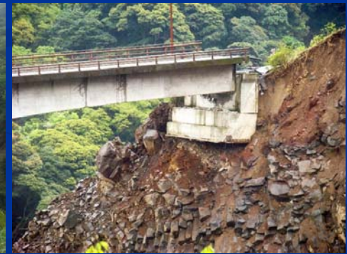
橋台周りの岩盤崩壊で不安定化
