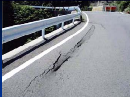
平成28年の路面陥没
