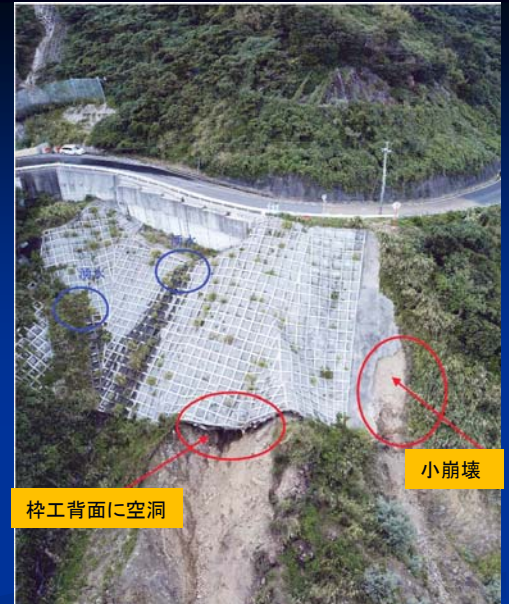
平成29年災 砕工の変状
