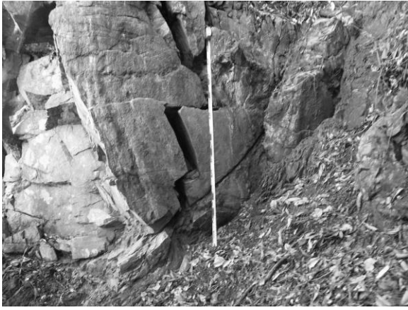
連続せず、雁行する亀裂
