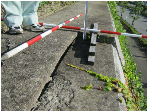
擁壁天端の段差
