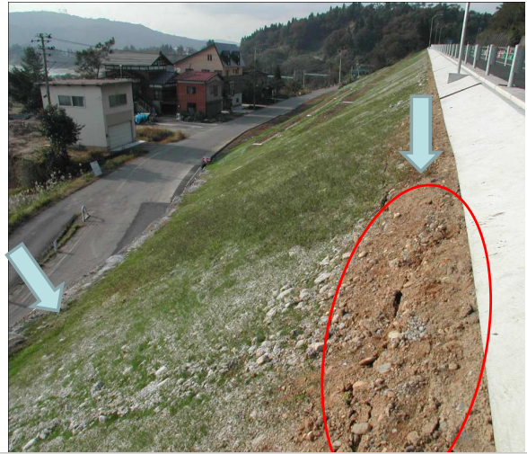
盛土上部の開口クラックとのり面のはらみ
