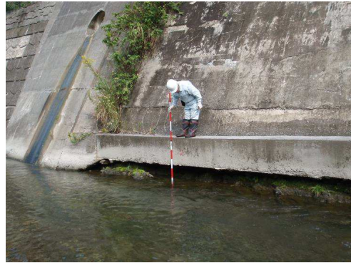
擁壁基礎の洗掘
