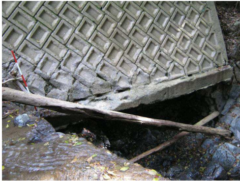
擁壁基礎の洗掘
