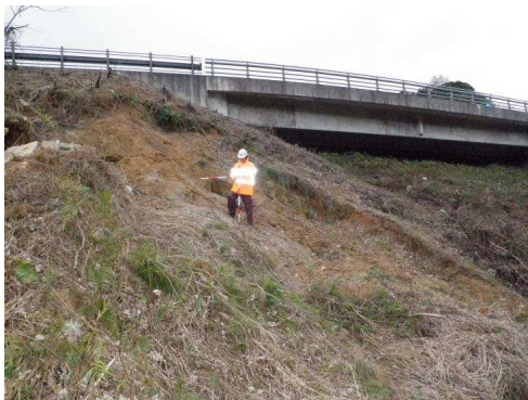
のり面の崩壊
