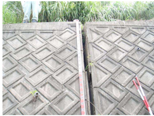
擁壁目地の開口
