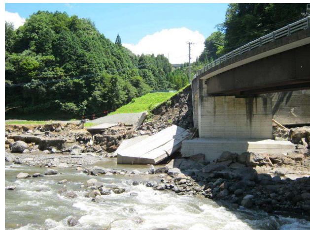
倒壊した橋台取付部の擁壁
