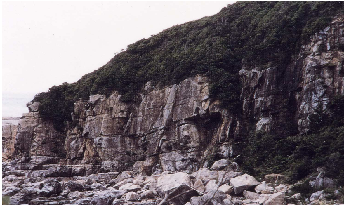
層理面とそれに直交する亀裂で立方体状の岩塊に区分されている硬質砂岩層
