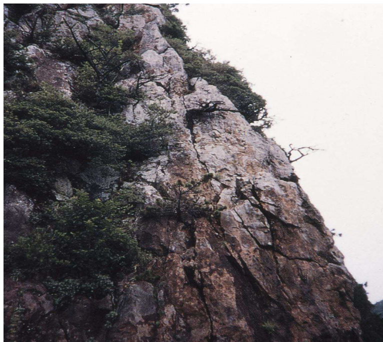
塊状の凝灰岩の岩盤表層に発生した不規則な亀裂
