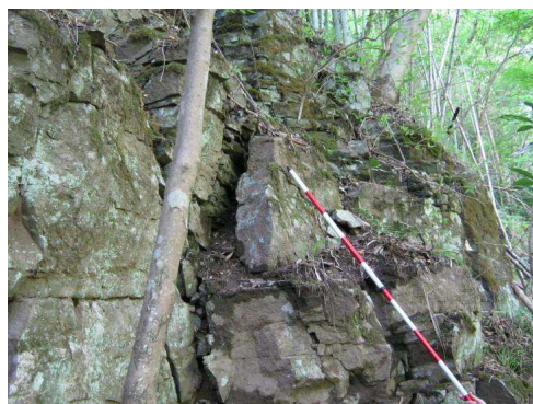
不安定な浮石
