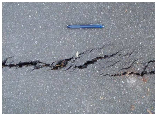
01_村道上斜面右側に発生した雁行状亀裂.JPG 2011/09/06 17:30:54
