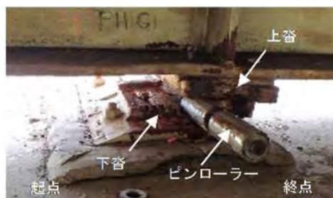
写真1 鋼製支承の損傷
