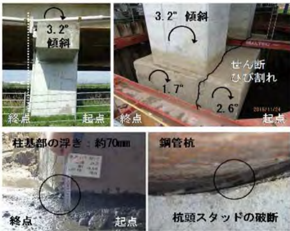
写真2 橋脚およびフーチングの損傷
