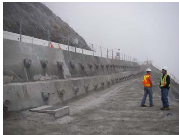
写真-33 道路直下のアンカー工 アンカー工は 4 段で施工、アンカー長は約 30~45 m、またアンカー工の上下は、約 4~6m のロックボルトを施工
