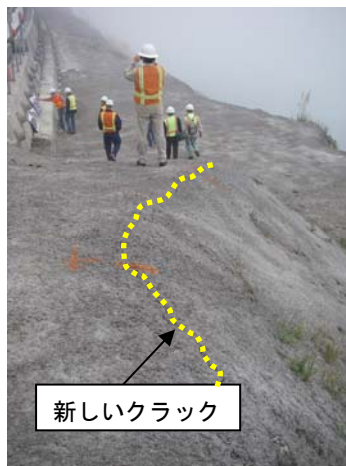
写真-34 吹付け部の新しいクラック
