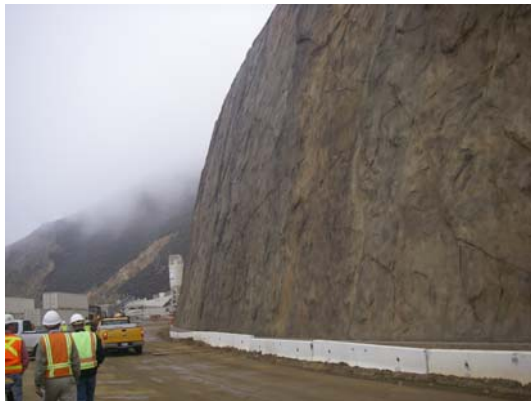
写真-41 南坑口南方切土部の偽岩擁壁 画面奥が南坑口（南より望む）。
