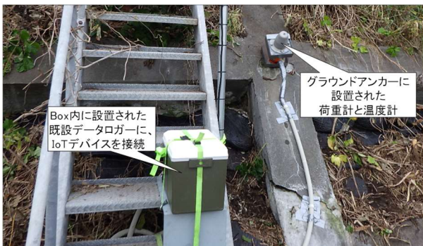
図-4 IoT デバイスの現場設置状況
