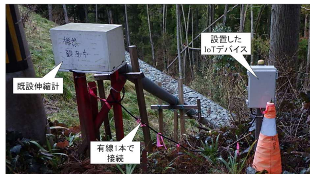
図-2 IoT デバイスの現場設置状況
