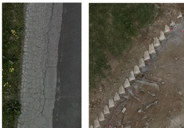
図-3 オルソ画像より確認できる堤防の特徴 (左:堤防面のクラック 右:被覆土工)
