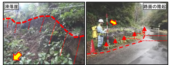
写真-1 地すべり滑動に伴う変状 (左写真:頭部の滑落崖、右写真:路面の隆起)
