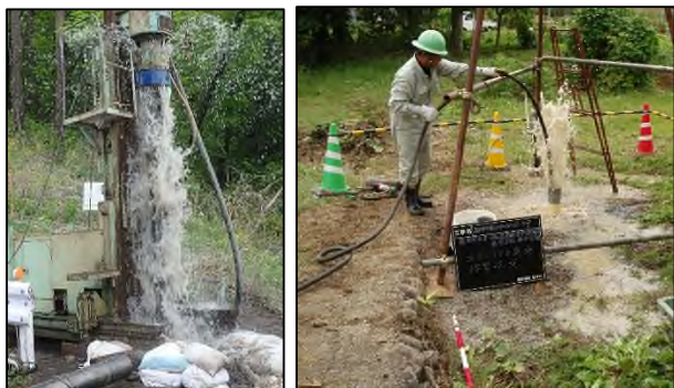
写真-1 さく井工事・井戸改修中の懸濁水発生状況
