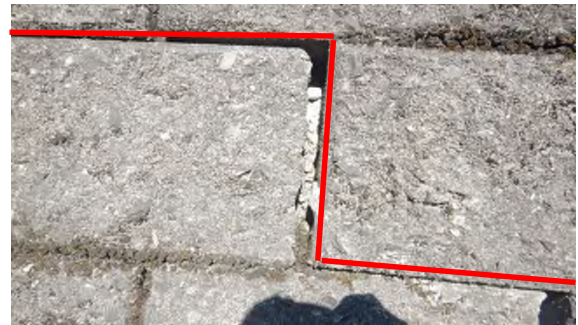
図-3 水路工の擁壁に発生した変状
