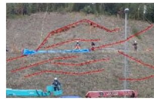
写真-11 法面クラック
