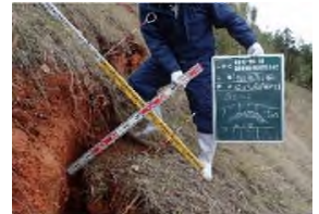
写真-12 クラック状況
