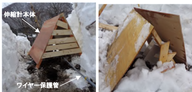
図-4 当初の雪対策と雪荷重による破損(S-2)
