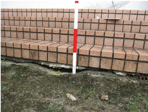
写真1 地盤沈下の状況
