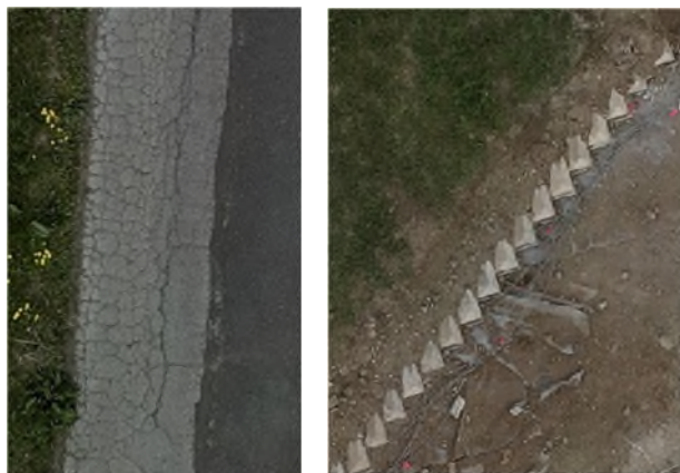
図-3 オルソ画像より確認できる堤防の特徴 (左:堤防面のクラック 右:被覆土工)
