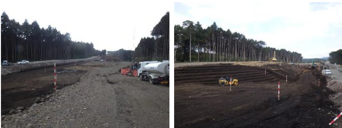
写真5 熊本県内の火山灰質粘性土分布域での盛土基礎処理事例
