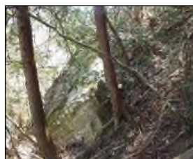
写真-2 不安定岩塊②
