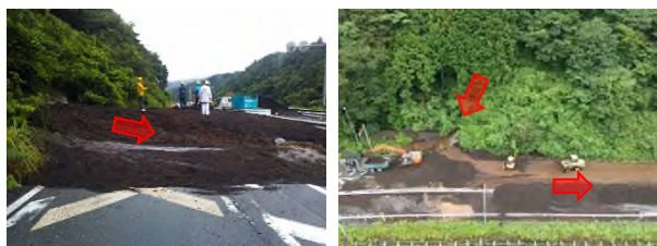
写真-1 本線被災時の状況
