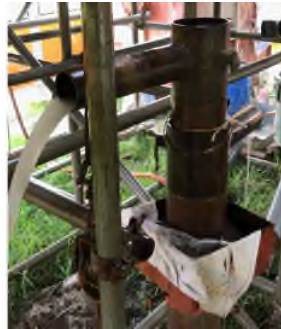
写真-1 湧水状況
