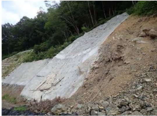
写1. 変状斜面全景
