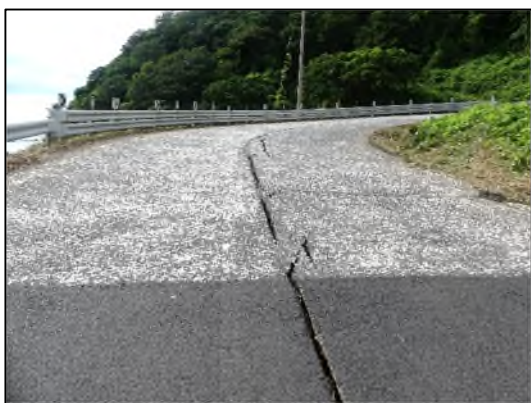
図-6 背後道路路面に亀裂が発達
