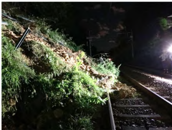
図-1 鉄道切土斜面の土砂崩壊
