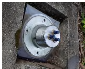
写真-3 露出状況写真(B-2)
