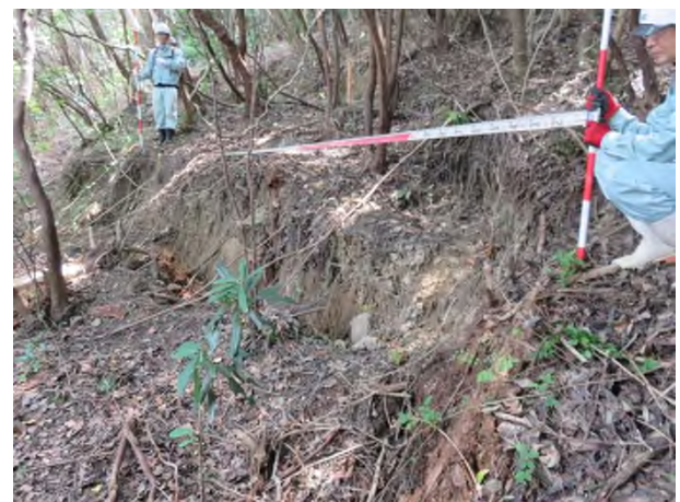
写真 4 ②ブロック右側方滑落崖状況(2)
