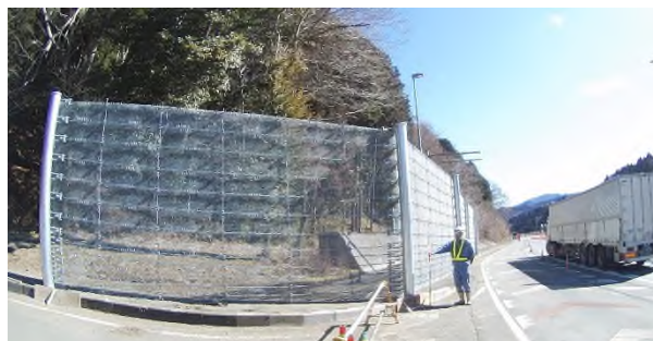
写真-4 施工が完了した高エネルギー型崩壊土砂防止柵工
