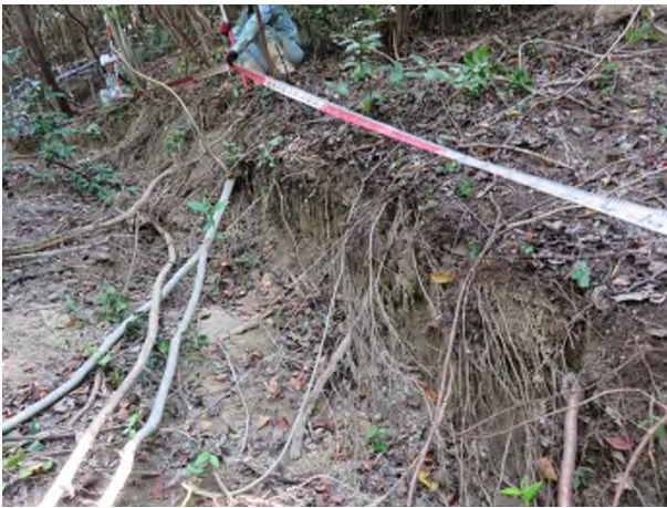
写真 3 ②ブロック右側方滑落崖状況(1)
