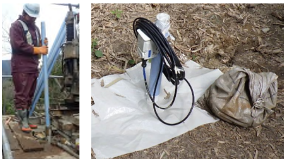
写真-1 自記水位計設置状況
