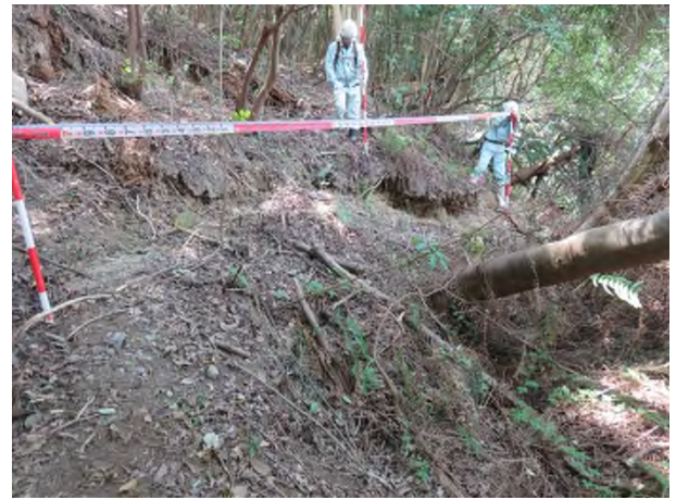
写真 2 ①ブロック中央～右側滑落崖状況
