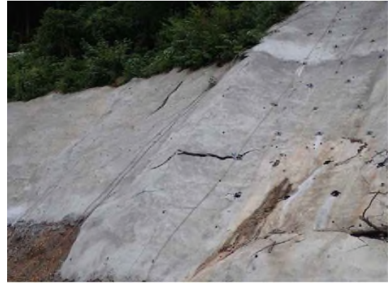
写2. モルタル吹付に発生したクラック
