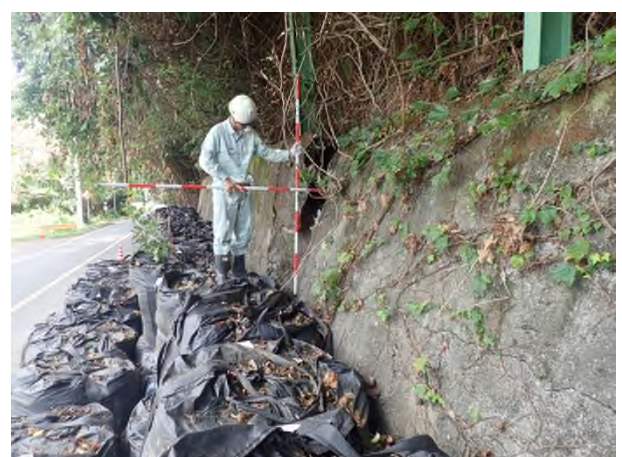
写真 6 地すべり土塊押し出しによる重力式擁壁の破損状況
