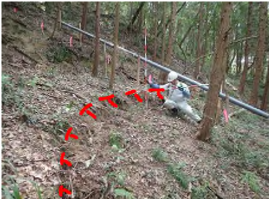
写3. 調査中の降雨で発生したクラック
