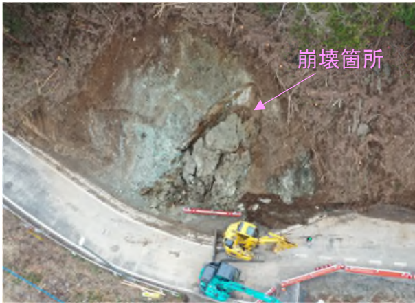
写真-1 岩盤崩壊状況 (埼玉県提供データ)
