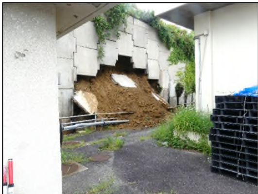
図-5 コンクリートスキンの崩落(位置は図-3参照)
