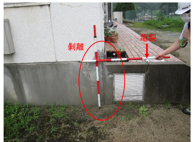
写真2 コンクリート構造物の剥離と亀裂
