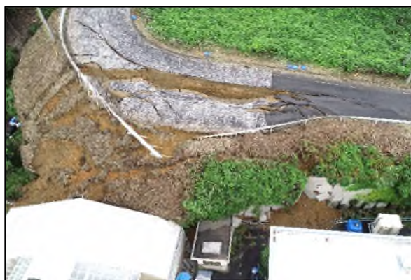
図-7 完全に崩壊
