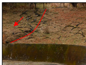
写真-2 法枠工変状状況
